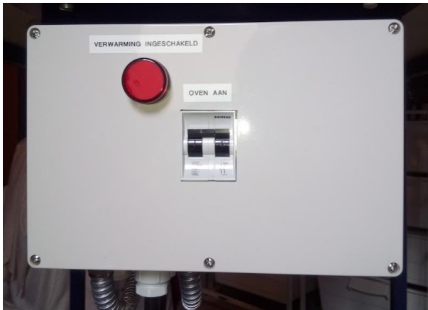
Figuur 3 Elektrische schakelkast
